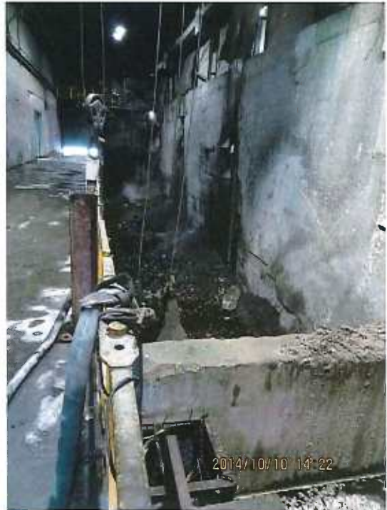
008.jpg Fosse de décantation et fosse à mâchefers
